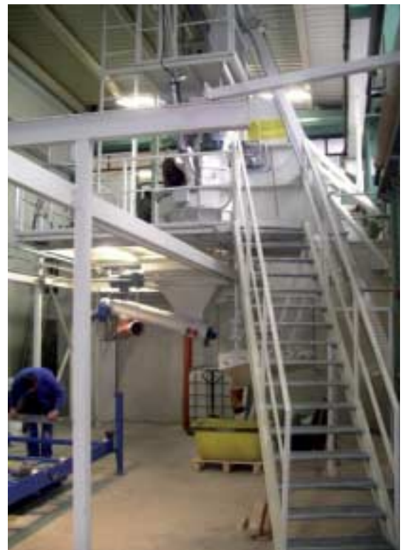
Fig. 2 General view of the complete mixing plant. Abb. 2 Gesamtansicht der kompletten Mischanlage.
