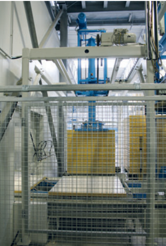
Der Umsetzer legt die Unterlagsplatten eines Pakets einzeln auf den Bretteinzug der Steinformmaschine
