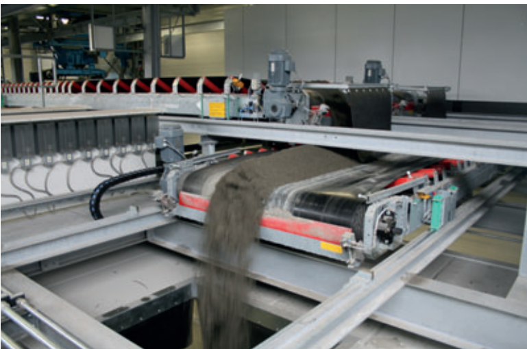
Die Gurtförderbänder von VHV Anlagenbau transportieren den Beton von den Mixern zur Betonsteinmaschine
