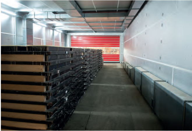
Einer der zwei neuen Trockenräume bei Bachtel, in denen die Produkte vor dem Entschalen trocknen.
